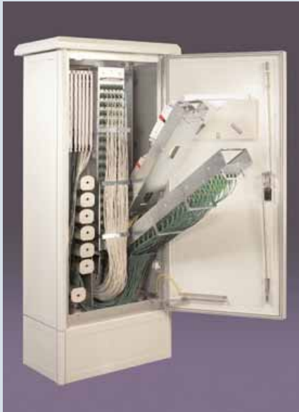
CSX Центральный шкаф для сплиттеров
